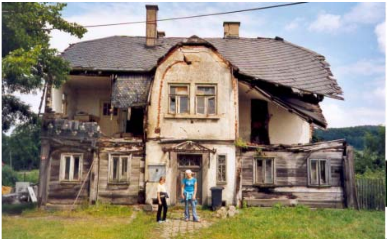
Česko vstupuje do EU - dům v Království č. p. 391 (foceno 6. 7. 2005). Text a foto: D. Petters
