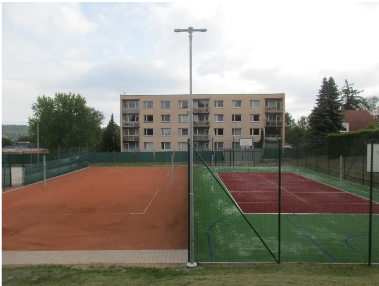
sloup nového osvětlení
