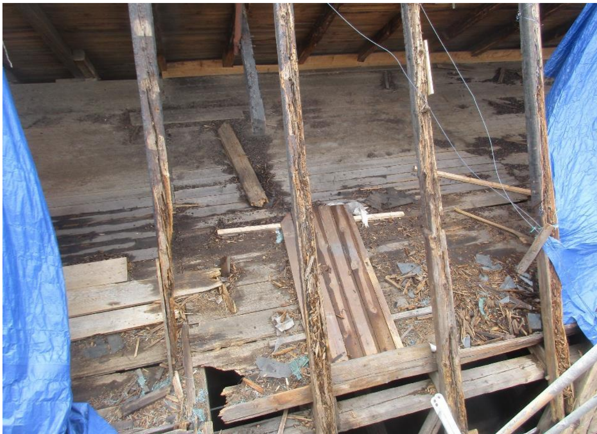
stav krokví severního průčelí
